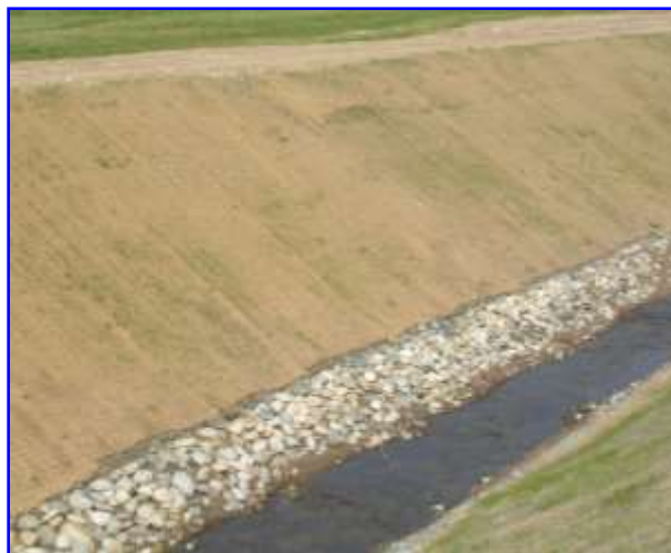
Foto 3 – Sistemazione ambientale di un canale realizzato con rivestimento al fondo in Materassi Metallico e rivestimento delle scarpate in geocomposito tipo RECS® IDRO
