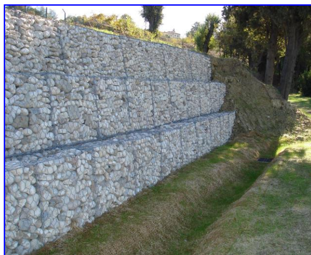
Foto 1 – Muro in gabbioni a consolidamento e drenaggio di un corpo gravitativo di materiali limoso-argillosi saturi.
