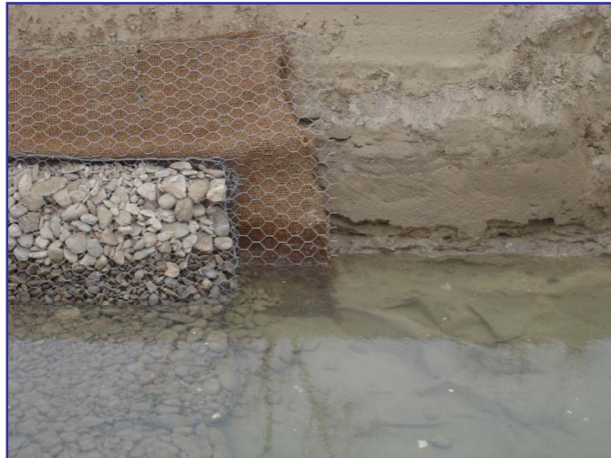
▲ Nel dettaglio si possono vedere il TNT separatore, il materasso metallico e il ricalzo del R.E.C.S. IDRO al di sotto di esso
