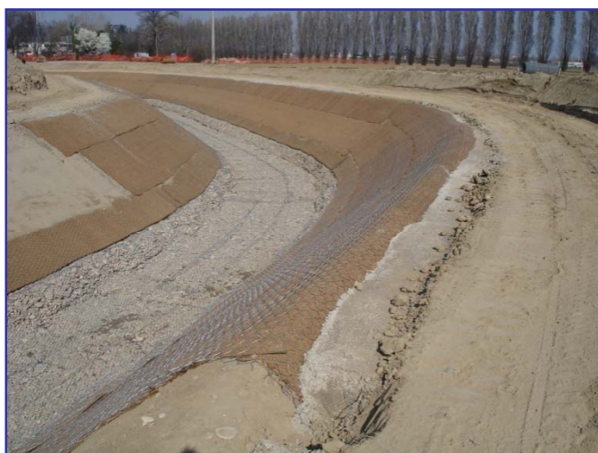
▲ Fasi realizzative: si noti la trincea trapezia di ancoraggio dei teli di Geocomposito in sommità riempita con calcestruzzo
