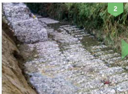
Fondazione con gabbioni cilindrici per una protezione spondale idraulica in gabbioni - inizio lavori
