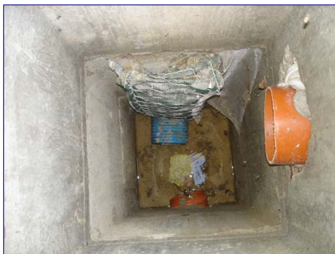
▲ Pozzetto di ispezione per la verifica del funzionamento del sistema drenante prefabbricato Gabbiodren™
