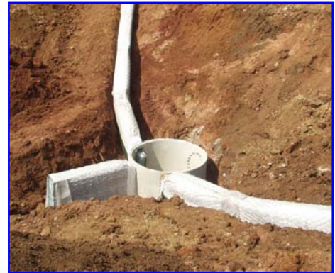
Foto 5 – Confluenza di alcuni rami di trincee Gabbiodren™ in un pozzetto di raccolta
