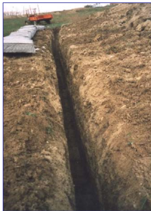
▲ Realizzazione della trincea a sezione obbligata e pannelli Gabbiodren™ allineati a bordo scavo
