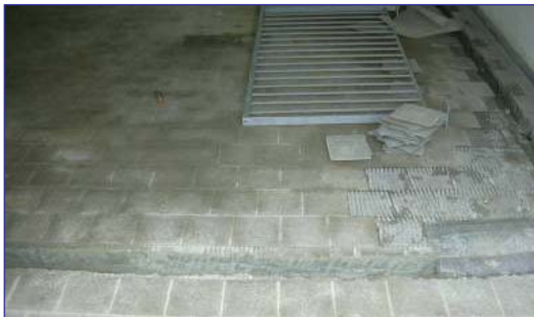
▲ Danni provocati dalle infiltrazioni su piastrellature e intonaci
